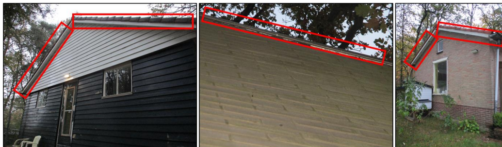
Figuur 1.3 Middels kierende kantpannen en kierende daklijsten kunnen vleermuizen toegang krijgen tot potentiële verblijfplaatsen in de bebouwing op de planlocatie.
