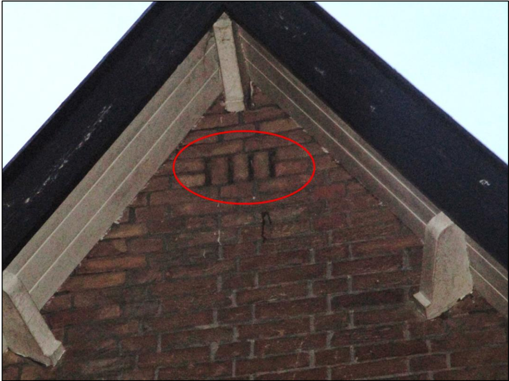
Figuur 5 Ventilatioorosters in woning J, waardoor vleermuizen hier een geschikte verblijfplaats kunnen aantreffen.
