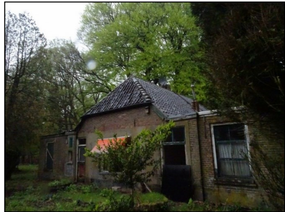
Figuur 10. Ruimtes bij scheefliggende dakpannen.
