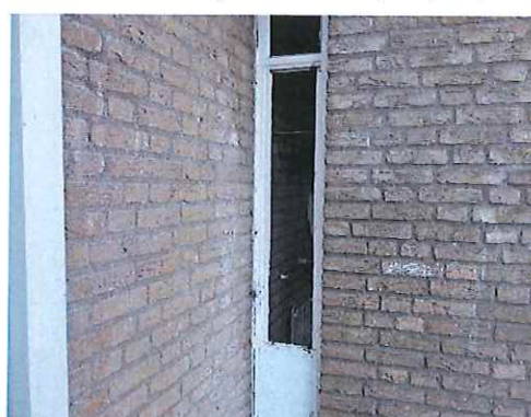
Foto 16: Sandwichpanelen (Abm/001) en kit tussen kozijnen en muren (Abm/004)
