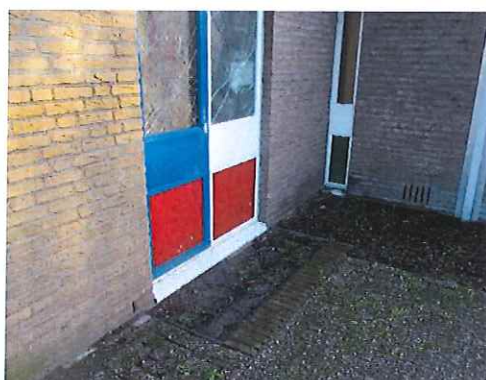
Foto 12: Sandwichpanelen (Abm/001) en kit tussen kozijnen en muren (Abm/004)
