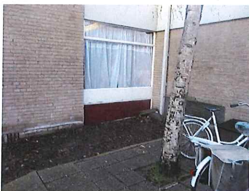
Foto 13: Sandwichpanelen (Abm/001) en kit tussen kozijnen en muren (Abm/004)
