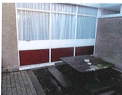
Foto 14: Sandwichpanelen (Abm/001) en kit tussen kozijnen en muren (Abm/004)
