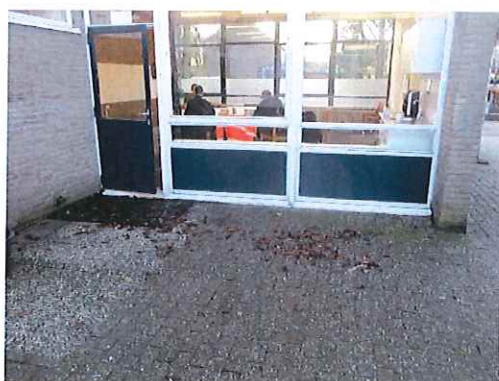
Foto 15: Sandwichpanelen (Abm/001) en kit tussen kozijnen en muren (Abm/004)
