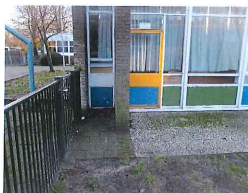
Foto 10: Sandwichpanelen (Abm/001) en kit tussen kozijnen en muren (Abm/004)
