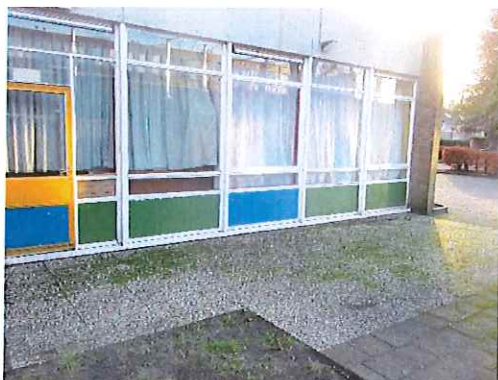
Foto 11: Sandwichpanelen (Abm/001) en kit tussen kozijnen en muren (Abm/004)
