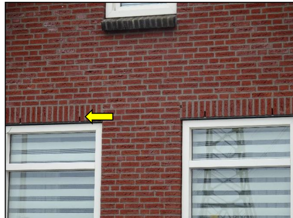
Figuur 34. Open stootvoegen, Deventerstraat 576, Apeldoorn.
