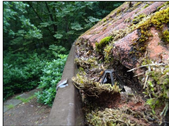
Figuur 22. Dakgoot noordelijk gelegen schuurtje.
