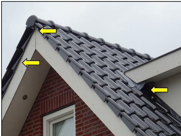
Figuur 33. Openingen onder de dakpannen en loodflapjes, Deventerstraat 576, Apeldoorn.
