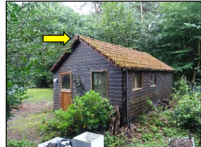
Figuur 32. Ruimtes onder dakpannen schuurtje.
