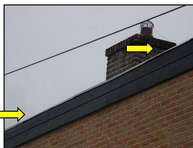
Figuur 29. Loshangend lijstwerk, Evert Jan Boksweg 26.
