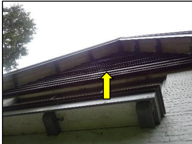
Figuur 30. Openingen tussen houten betimmering met potentiële ruimtes voor vleermuizen.
