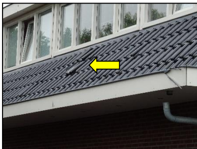
Figuur 23. Losse dakpannen kunnen toegang tot ruimtes onder het dak bieden.
