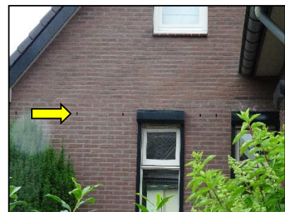
Figuur 27. Open stootvoegen, Achterste Kerkweg 2.
