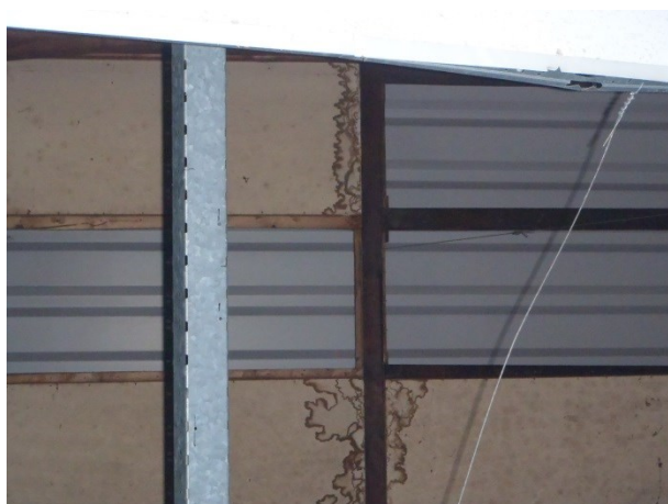
Foto 6: het geïsoleerde dak met ontbrekende isolatieplaten. Het stalen profiel van de dakplaten is zichtbaar.
