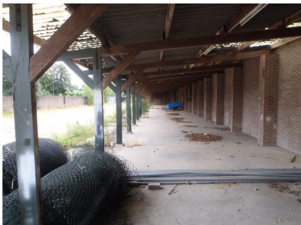
Foto 1: overkapping, op de aanwezige balken zijn door duiven nesten gebouwd.
