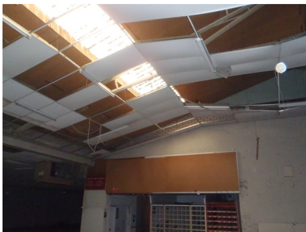
Foto 5: binnenzijde van de hal met zichtbaar het systeemplafond, daarboven bevindt zich de isolatielaag tegen de dakplaten. Evenals het systeemplafond zijn ook de isolatieplaten deels verdwenen.
