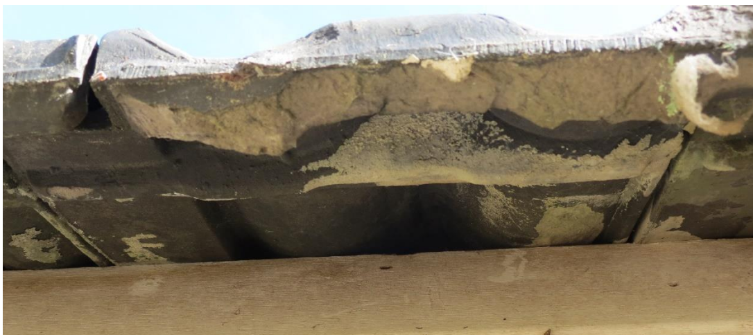
ontbrekende dakgoten en dichtgemaakte openingen
