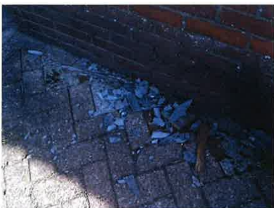
Foto 5: Op de bestrating rond e stallen ligt veel asbestverdacht materiaal (restanten dakplaten).
