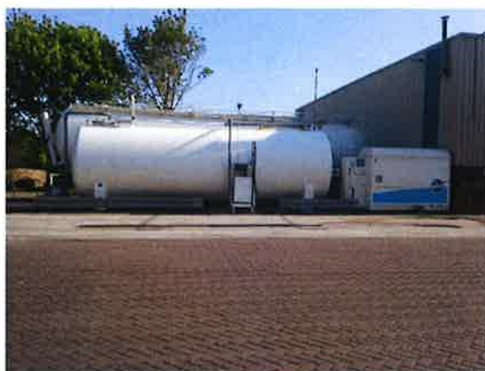
Foto 2: Bovengrondse 40.000 liter dieseltank met brandstofpomp en voorliggende was-/ tankplaats. Daarvoor de plek waar de toekomstige was-/tankplaats wordt gerealiseerd.
