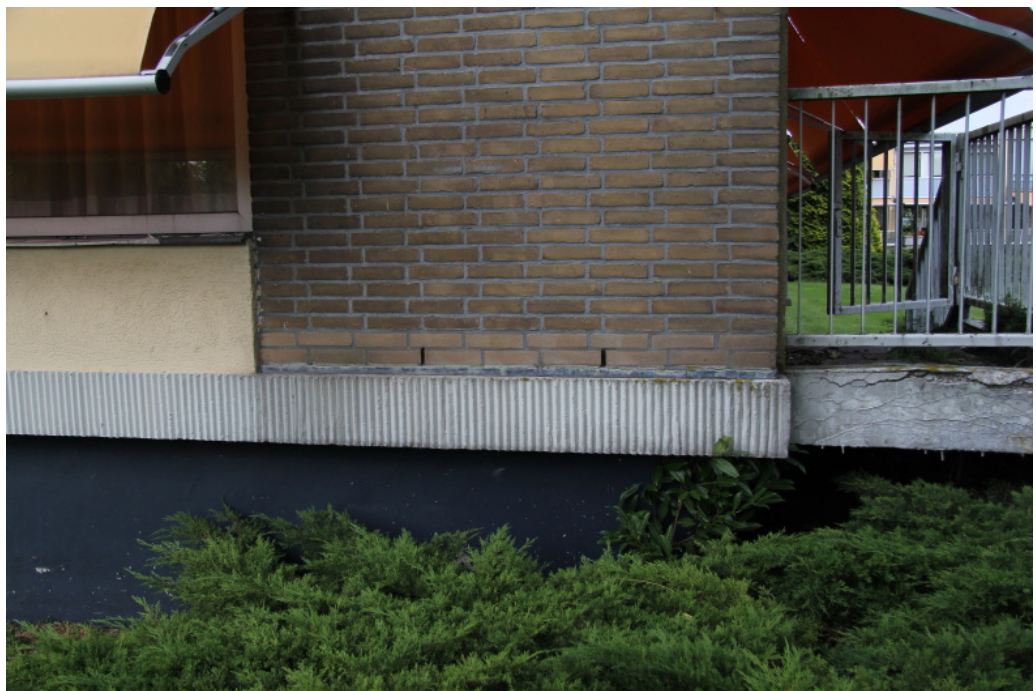
Fig. 8. Open stootvoegen in de gevel boven de vloerplaat.
