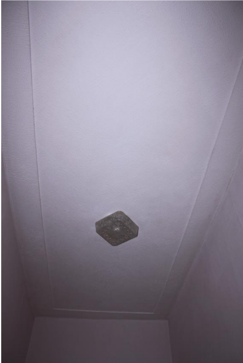
Stucplafond boven de voormalige overloop op de verdieping.
