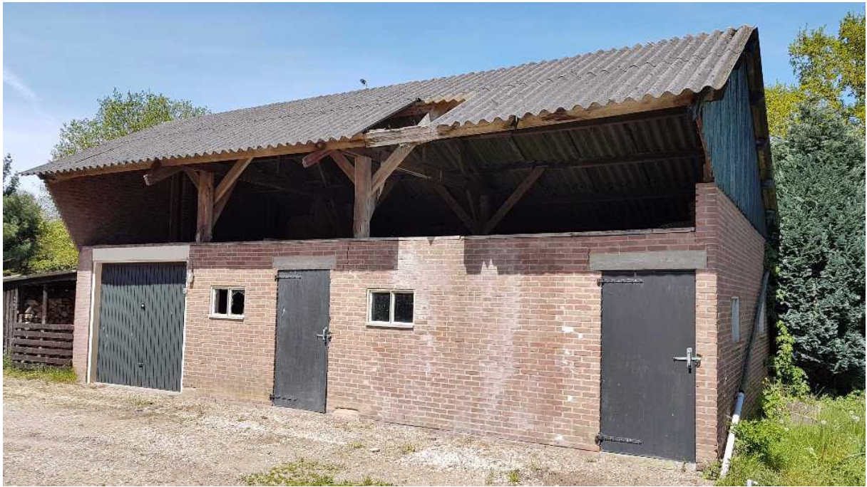
Foto 1: bestaande schuur met asbestverdachte dakbeplating zonder dakgoot aan de voorkant
