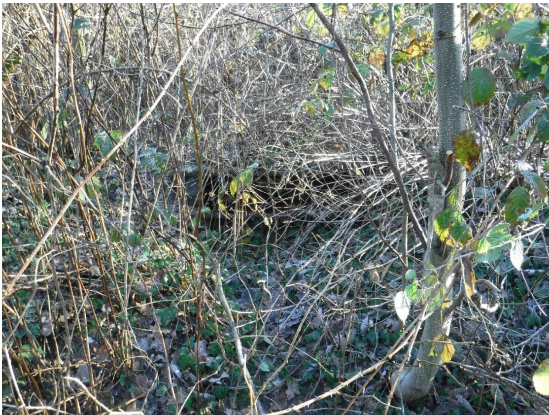
Afbeelding 10 Restanten van de betonnen overkluizing van de sprengbeek
