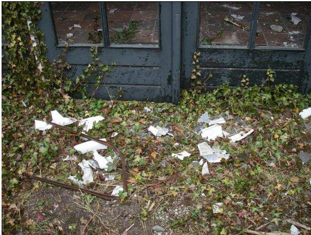
Foto B2.4 Asbest op maaiveld
