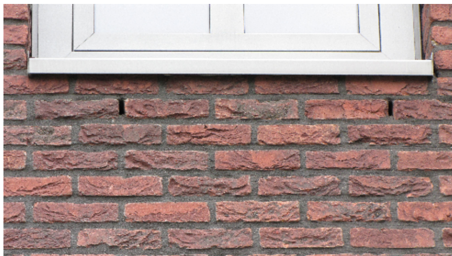
Figuur 6. Open stootvoegen in een van de gebouwen in het plangebied waardoor vleermuizen van de spouwmuur kunnen gebruik maken.
