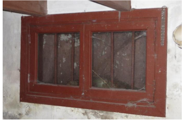
Figuur 16: Kelder onbereikbaar
