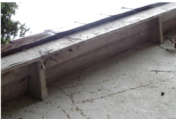
Figuur 15: Daklijsten dicht en ongeschikt
