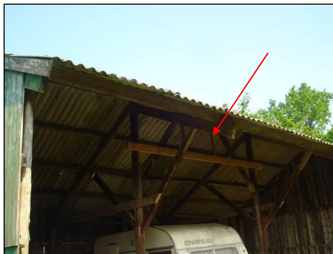
Foto 8: Loods: Golfplaten dak (M02AA)
