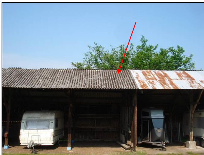
Foto 7: Loods: Golfplaten dak (M02AA)
