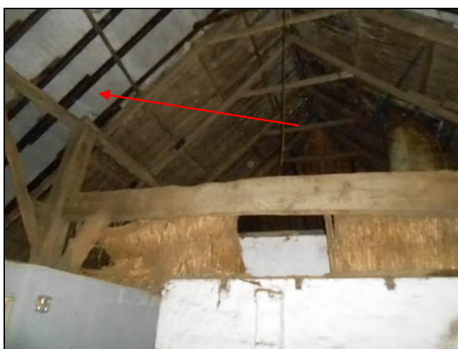
Foto 11: Voorhuis: Dakbeschot (M01AZ)
