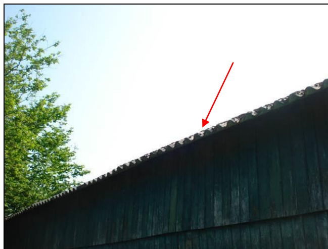
Foto 6: Loods: Golfplaten dak (M02AA)
