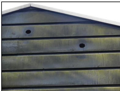
Figuur 10. Gaten in betimmering (nr. 98).
