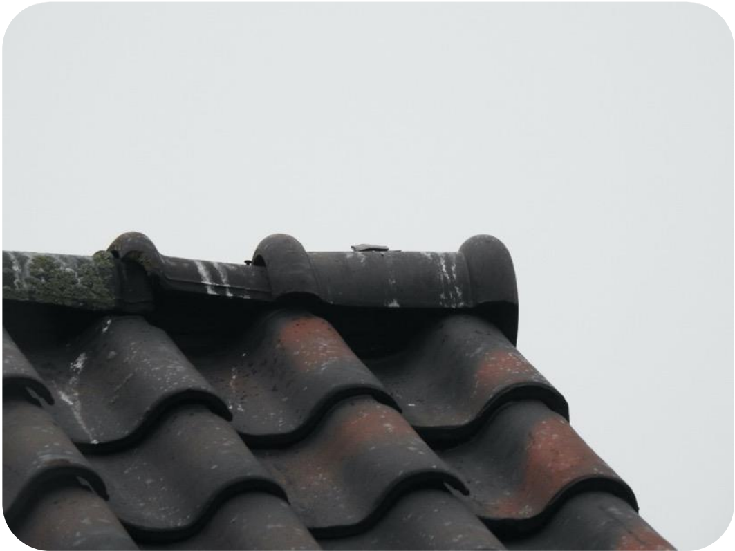
Afbeelding 20, spreeuwen nestelen onder de dakpannen van het hoofdgebouw
