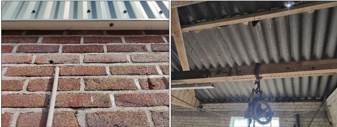
Links een foto waarop te zien is dat de damwandplaten aan de zijgevel van de schuur niet kiert, rechts een foto waarop te zien is dat het dak van de schuur niet geïsoleerd is.
