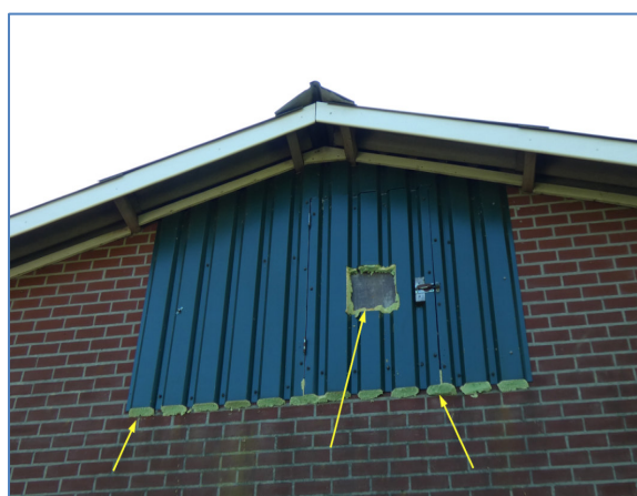
Foto 14 afdichtingen kieren gevel N planloc. 2
