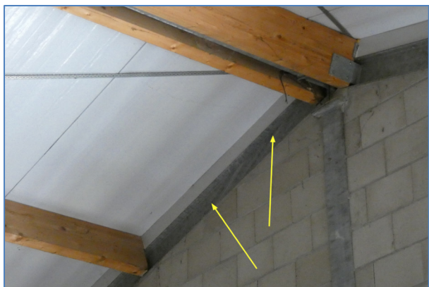
Foto 27 strakke afdichting in planlocatie 1
