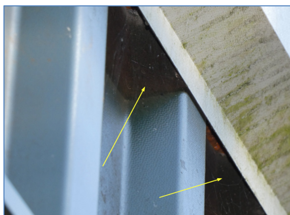
Foto 22 afdichtingen open golven gevel plan 5
