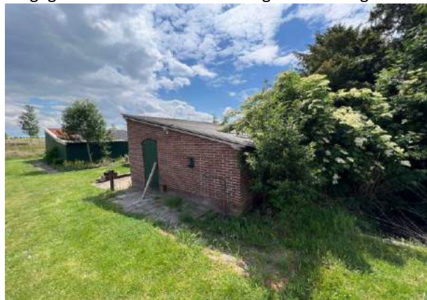
Figuur 13: Schuur asbestverdacht golfplaten dak
