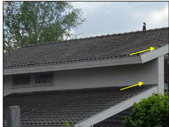
Figuur 12. Stootvoegen boven de garage en schuin liggende dakpannen.
