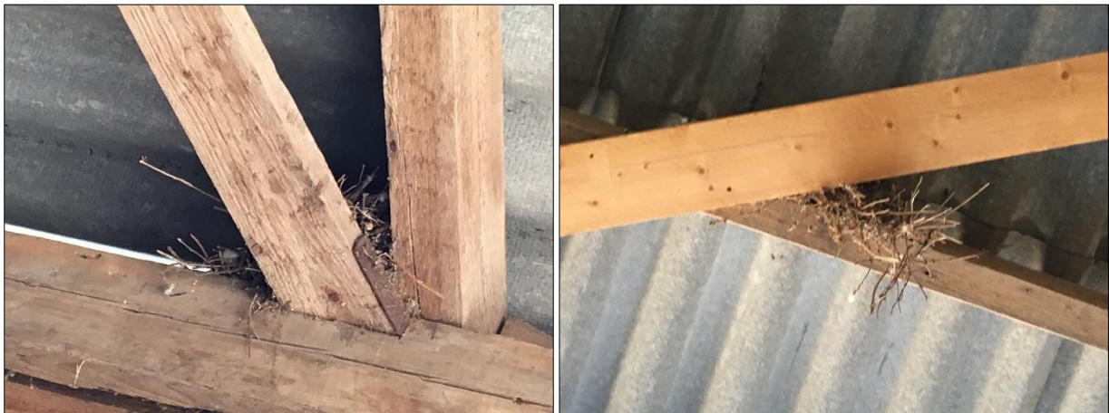
Oude holen- of houtduivennesten aangetroffen in de te slopen kapschuur.
