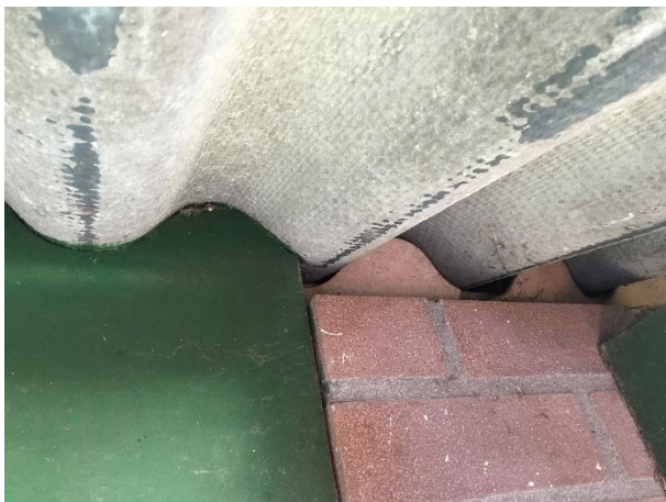
Nokken van de golflaten zijn afgedicht waardoor vogels en zoogdieren niet onder de golflaten kunnen komen.
