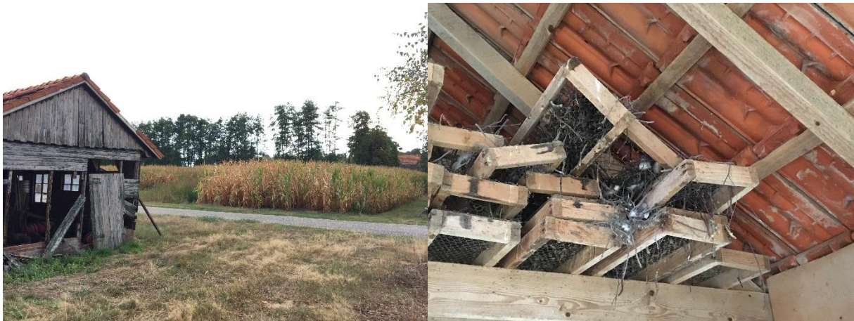
De schuur is voor vogels toegankelijk maar beschikt niet over dakbeschot/dakisolatie.
