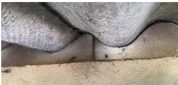
Door de nokken van de golfplaten af te dichten, wordt voorkomen dat de steenmarter een vaste rust- of voortplantingsplaats in de stal bezet.
