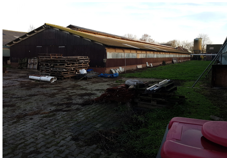
Te saneren pluimveestal.
