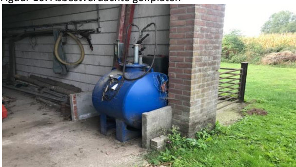
Figuur 18: Bovengrondse dieseltank
