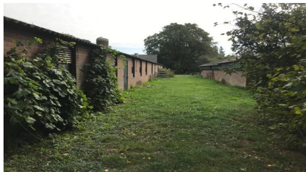
Figuur 17: Asbestverdachte golfplaten
