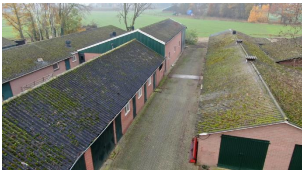
Figuur 16: Asbestverdachte golfplaten
