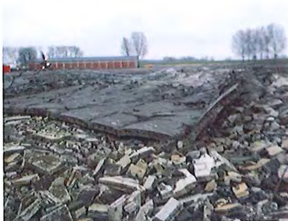
Foto 3. Situatie – deelloverzicht. Puin met voornamelijk vuurvast materiaal, beton, hydrokorrels en isolatiemateriaal.
