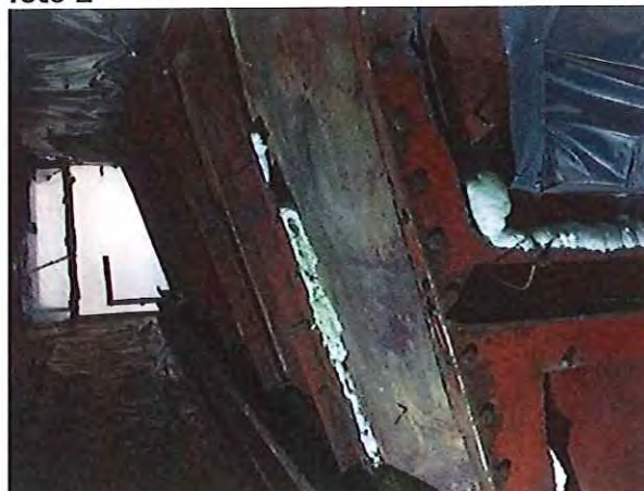
Foto van vrijgave containment voorbeeld uitstroom kanaal ketel 1
