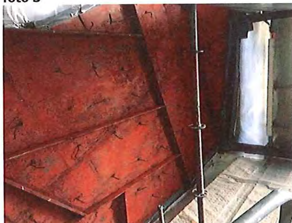
Foto van vrijgave containment voorbeeld uitstroom kanaal ketel 1
