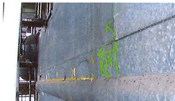
Foto 2. Penthouse: Wand tussen ketel 50 en 4 oude situatie (2017-003)
