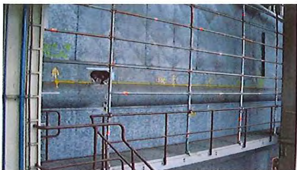
Foto 1. Penthouse: Wand tussen ketel 50 en 4 oude situatie (2017-003)
