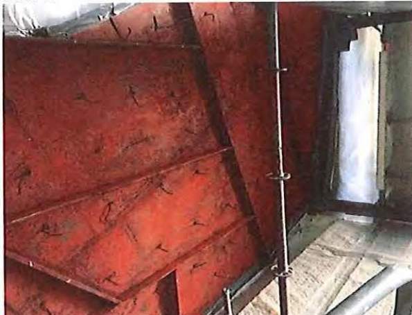
Foto van vrijgave containment voorbeeld uitstroom kanaal ketel 1
