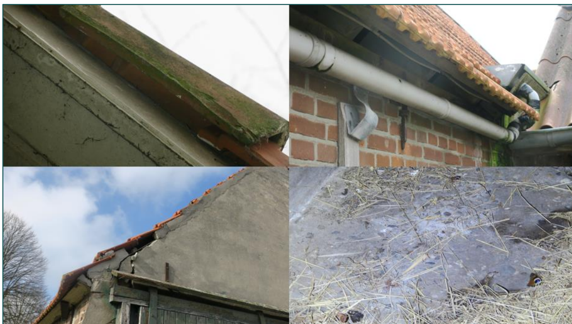
Figuur 3.2 De bebouwing op de planlocatie is toegankelijk voor gebouw bewonende vleermuizen via o.a. kierende kantpannen, weggevallen specie en missende dak delen (boven en linksonder). Ook zijn mogelijk sporen aangetroffen van de gewone grootoorvleermuis (c.q. afgebeten vlindervleugels)(rechtsonder).
