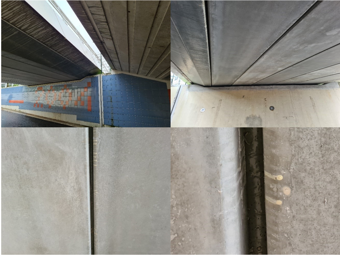
Afbeelding 3.9 Spleten in bestaande fietstunnel Veerallee, deze zijn te ondiep om een geschikte verblijfplaats voor vleermuizen te vormen
