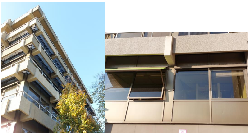
Figuur 1.2 Indicatie van het gebouw met de balkons (links) en de vogelwerende pinnen op de zonwering (rechts). Een overzichtsfoto is te vinden op de voorpagina.
