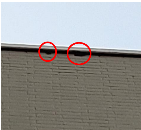
Figuur 4.1 De daklijst op het stenen geveldeel aan de noordzijde en de openingen (rood omcirkeld) net onder de daklijst welke mogelijk toegang bieden tot de spouwmuur.
