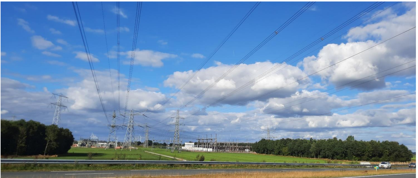
Figuur 2-1: Huidige situatie hoogspanningsstation Zwolle Hessenweg.
