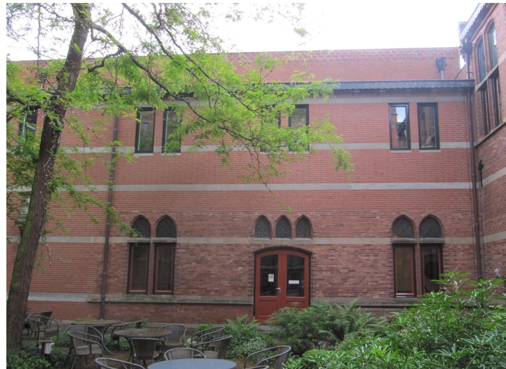
Gevel van de Commissaris des Konings vleugel aan de binnenhof zijde. Met de bouwsporen van de ophoging en de wijzigingen aan het venster.
