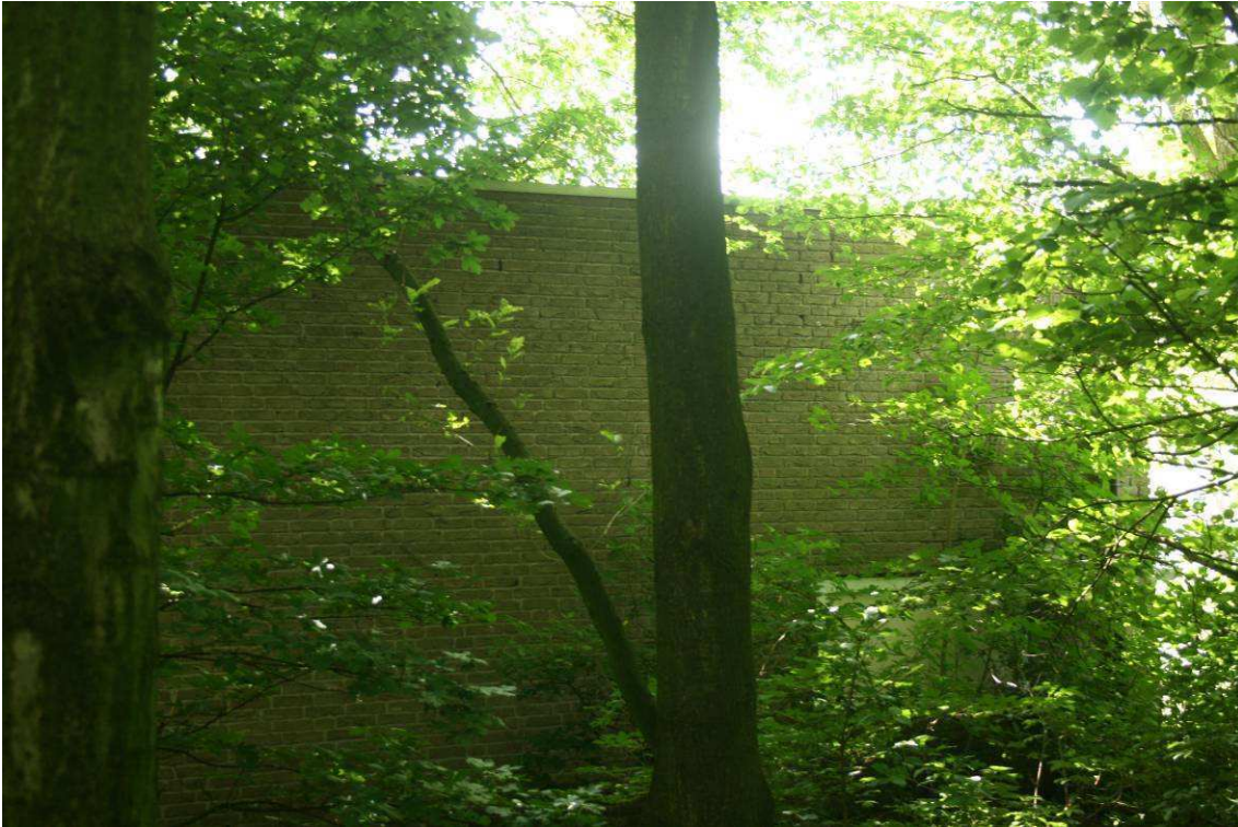
Figuur 6: aanwezige spouw-gaten
