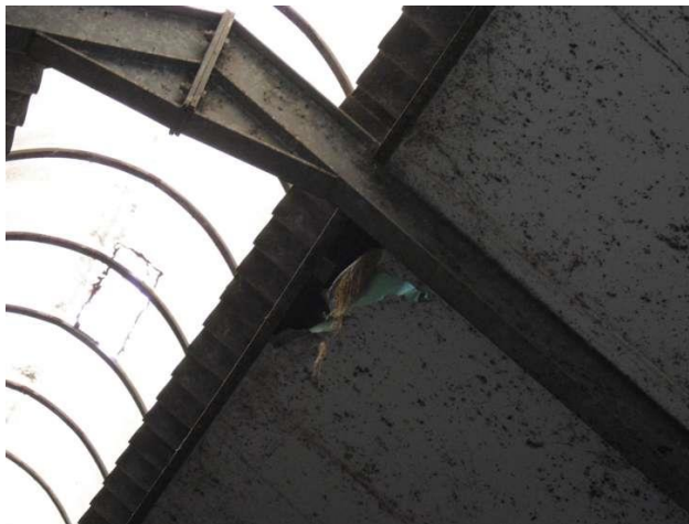
Afbeelding 4: Losgeraakte dakbedekking met mogelijk nestmateriaal. Gezien de aanwezigheid van huismussen kan dit wijzen op broedgevallen van deze soort (Foto's: SAB, 2013)
