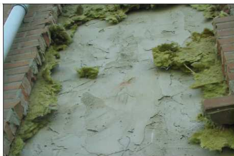
Bij deze blootgelegde spouwmuur is een voor vleermuizen goed (ruw) afgewerkte muur te zien, maar door het contact met het isolatiemateriaal is deze ruimte zo goed als ongeschikt voor vleermuizen; door ruw plaatmateriaal tegen het isolatiemateriaal te bevestigen ontstaat een voor vleermuizen geschikte verblijfplaats.
