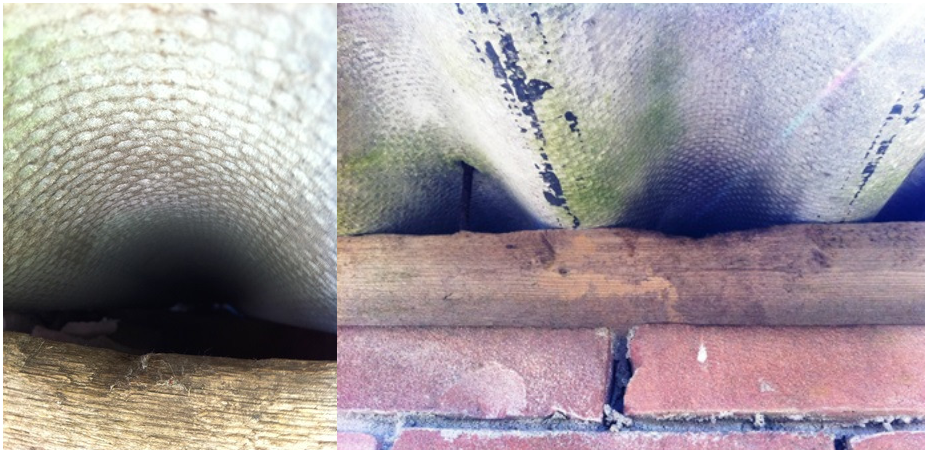
Smeerrand op muurplaat en gebruikspoor van een zoogdier of Steenuil.
