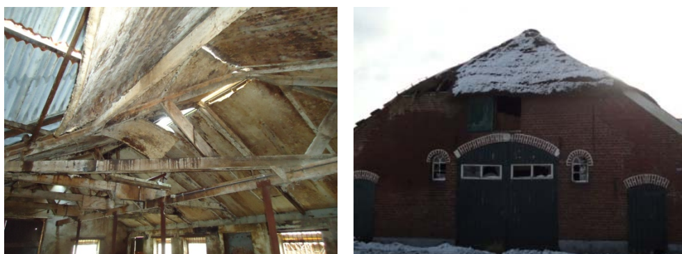
Foto's: Impressies slechte staat opstallen.
