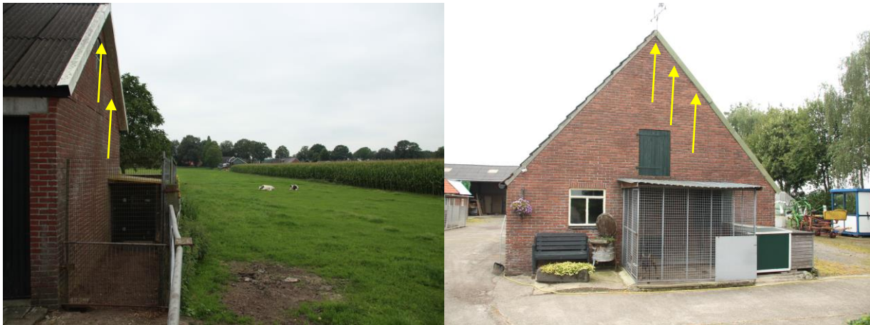
De betimmering van het dakoverstek en daklijsten sluiten niet strak aan op de buitengevels (gele pijlen).
