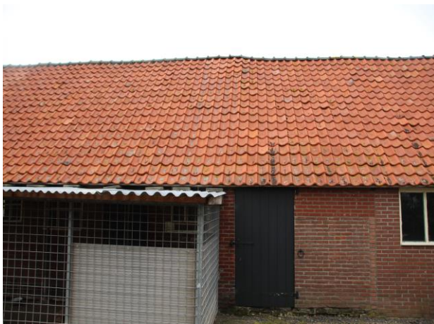
Er zijn kieren/openingen onder de dakpannen van de bebouwing vastgesteld.
