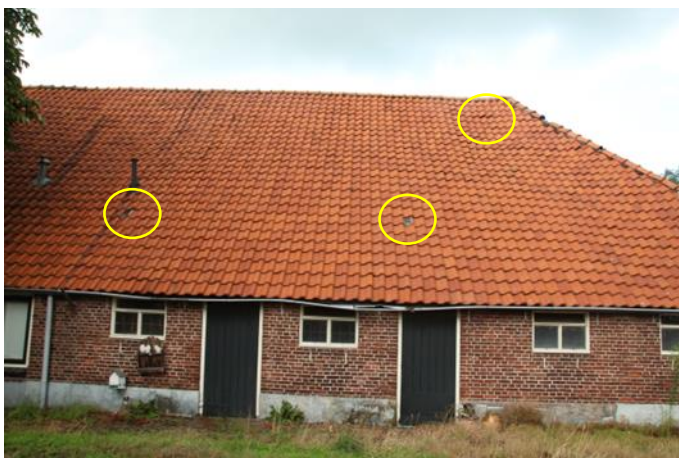
Er zijn kieren/openingen onder de dakpannen van de boerderij vastgesteld (gele cirkels).
