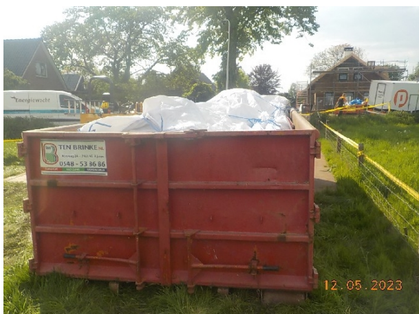
3. Container verpakt asbest
