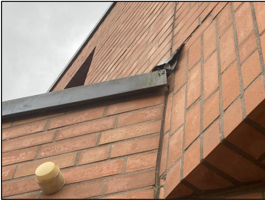
Figuur 6.1: Kieren achter de daklijsten.
