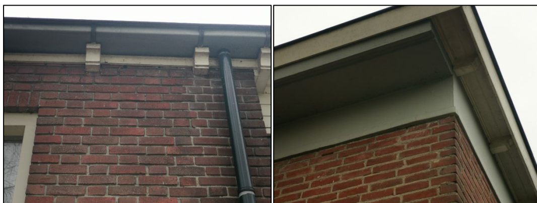
Figuur 2.7 en 2.8: Impressie daklijst, deze sluit goed aan op het gebouw. Enig kieren zijn bedekt met spinnenweb.
