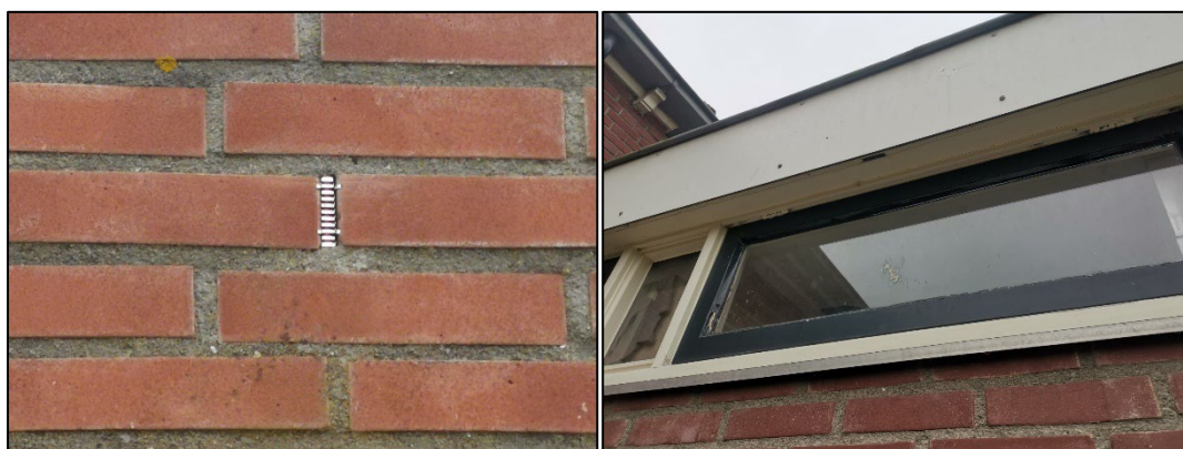
Figuur 2.9: Afgesloten stootvoeg (links), welke rond het gehele gebouw aangebracht zijn. Figuur 2.10: Opening in daklijst (rechts), afgesloten met spinnenweb.
