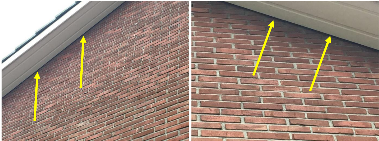
Openingen tussen het dakoverstek en de buitengevels vormen potentiële invliegopeningen voor vleermuizen om de spouw te bereiken.
