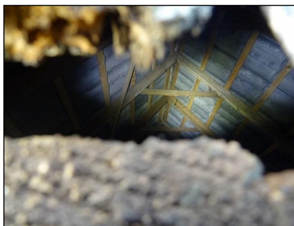
Figuur 12. Dakbedekking van een van de bijgebouwen. Duidelijk te zien dat hier geen dakbeschot aanwezig is.
