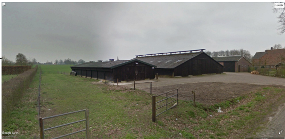
bestaande schuren met asbest
