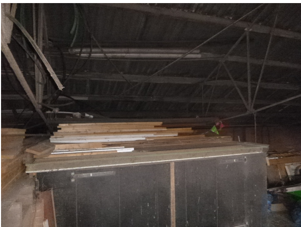
schuur 3 onderkant dak
