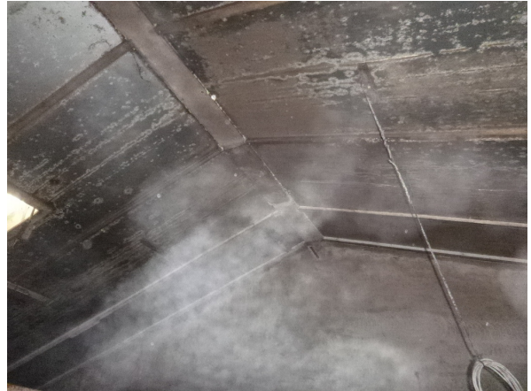
onderkant dak varkensstal
