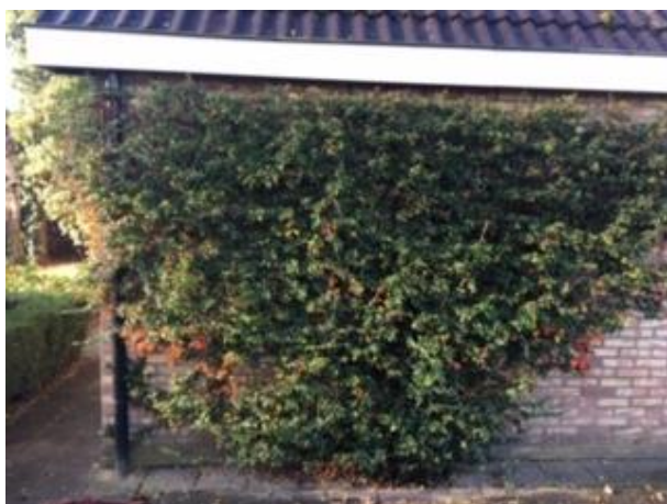
Klimop aan de muur van de woning. Potentiële nestplaats voor vogels.
